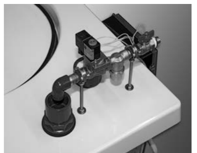
Niveau- und Pumpensteuerung, mit Magnetventil
