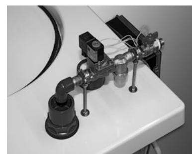
Niveau- und Pumpensteuerung, mit Magnetventil
